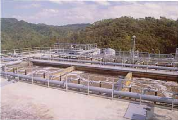
■産業廃棄物埋立場浸出汚水処理設備
