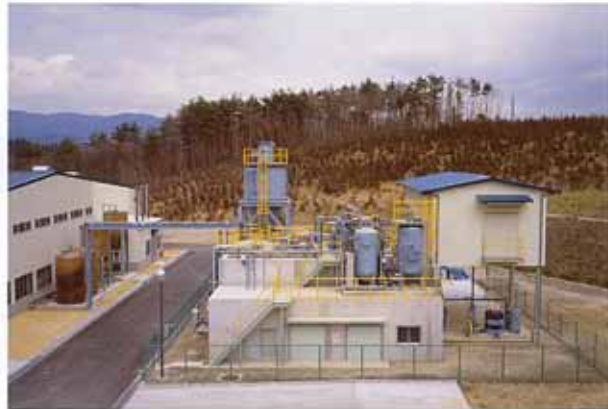
■産業排水の高度処理設備
