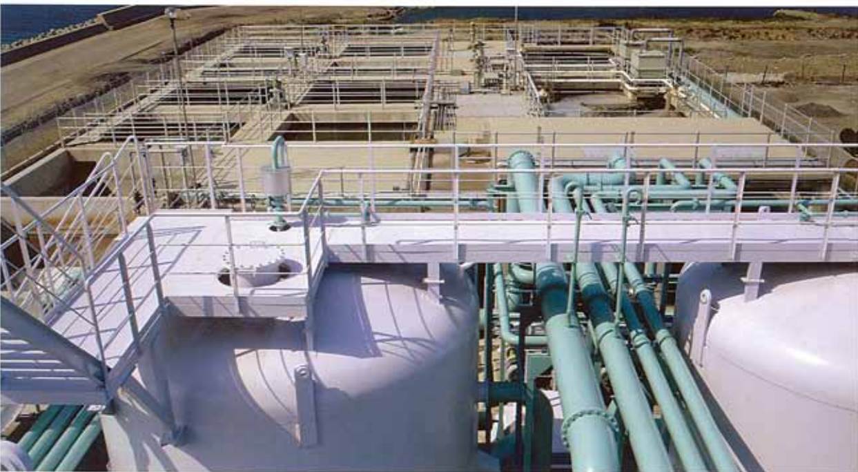
■一般廃棄物埋立場浸出汚水処理設備
