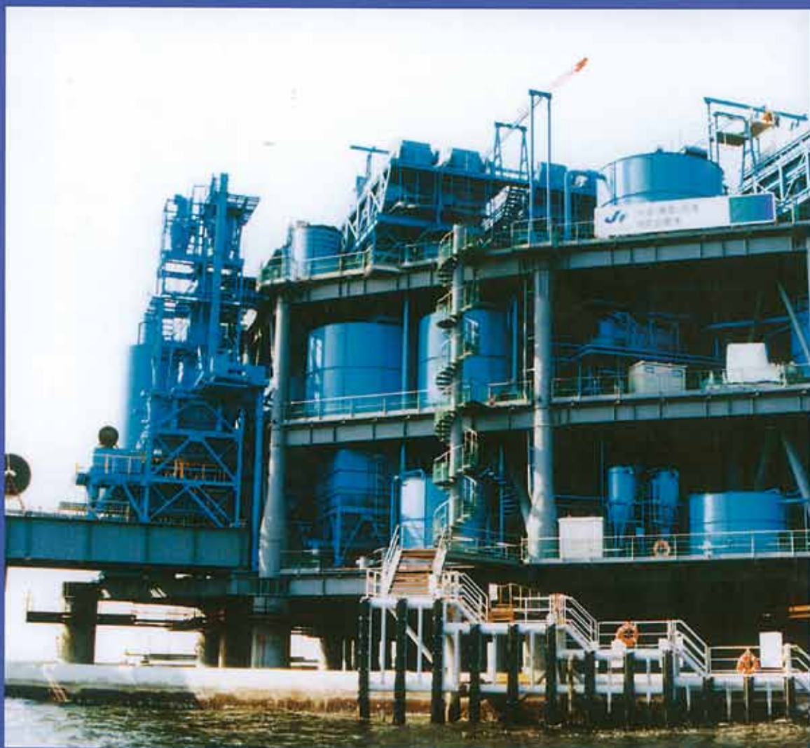
シールド泥水処理設備 (東京湾横断道川崎人工島)
