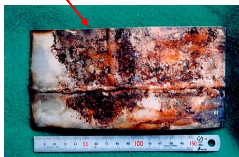
タンク表面の腐食
